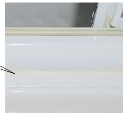
掃除後(浴室入口)
